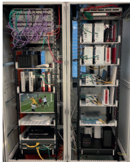
Messen rund um die Uhr: Die automatisierten Testsysteme enthalten die Router der Testanschlüsse, Rechner zur Steuerung und Auswertung sowie eine Firewall.
