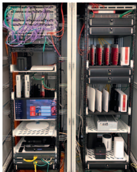
Messen rund um die Uhr: Die automatisierten Testsysteme enthalten die Router der Testanschlüsse, Rechner zur Steuerung und Auswertung sowie eine Firewall.
